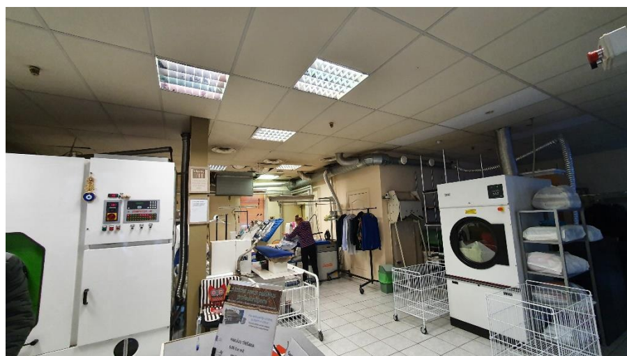
5.9.1.4. attēls. Gaismekļi ķīmiskā tīrītavā.
