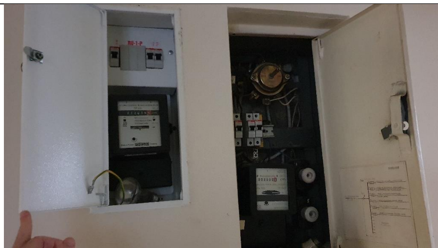
5.9.1.3. attēls. Elektriskās uzskaites sadalnes 2. stāvā.
