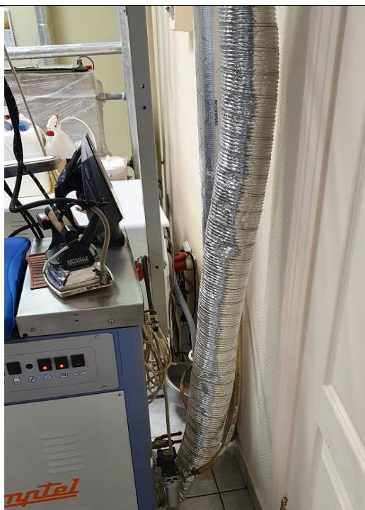
5.6.1.7.attēls. Pievienojums tehnoloģijai. Lokālais gaisa vads ir daļēji deformēts
