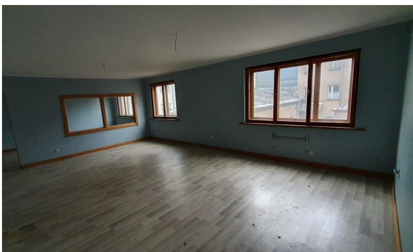
5.5.1.3.attēls. 2.stāva telpas bez apkures sildķermeņiem
