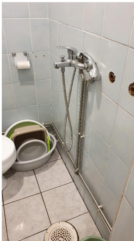
5.1.1.2. attēls. Dušas pieslēgums, metāla ūdensvada caurules pie sienas.
