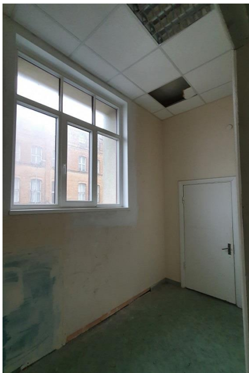
5.5.1.4.attēls. 2.stāva telpas bez apkures sildķermeņiem
